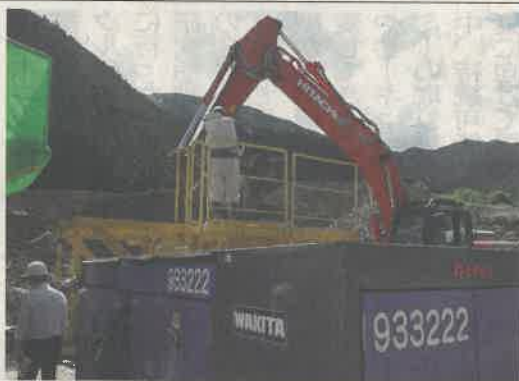
プラント投入口
