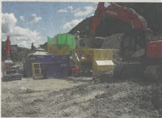
実証プラント
